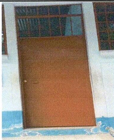
Foto 3: PINTURA EN PUERTAS
